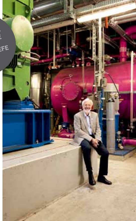
Eine Vision wurde Wirklichkeit: Erwin Knapek, 69, im Maschinenraum des Heizkraftwerks Unterhaching
